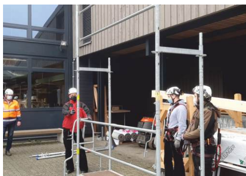
Gerüst nie „ohne“! Entweder integrierter vorlaufender Seitenschutz oder Montagesicherungsgeländer.
